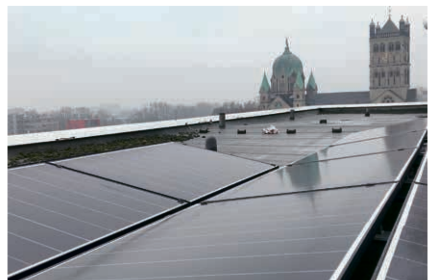
Die Photovoltaik-Anlage auf dem Dach des Gebäudes Meererhof 1 spart eine große Menge CO 2 ein.
